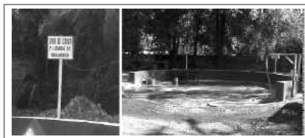
Figura 41. Pozo de almacenamiento de agua residual
