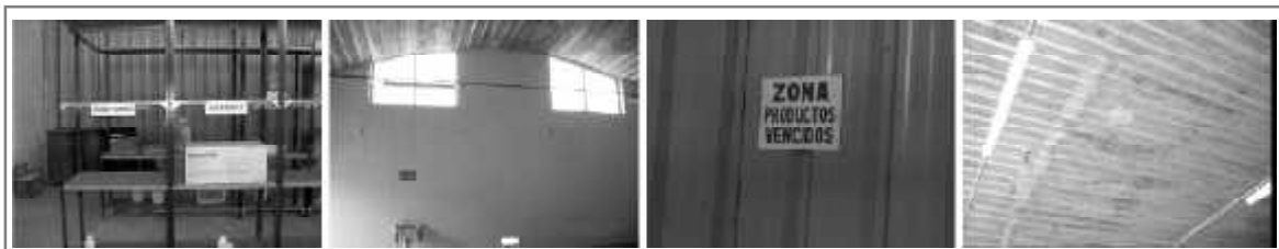
Figura 42. Instalaciones de almacenamiento de pesticidas
