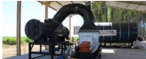
FOTO 28 | Sistema de geração de energia elétrica que utiliza turbina (em instalação), o biogás é queimado para gerar o vapor que movimenta a turbina. Capacidade de geração de 2500 kVA
