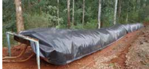
FOTO 26 | Balão pulmão com depósito de biogás, pré-gerador.
