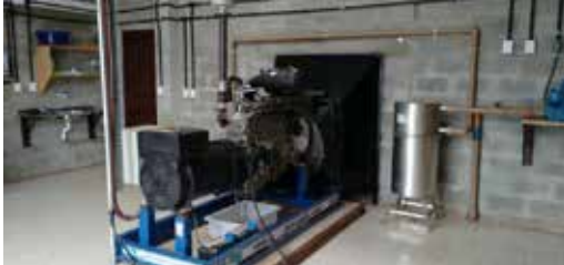
FOTO 23 | Gerador de energia a biogás com sistema de filtragem prévia do gás sulfídrico.
