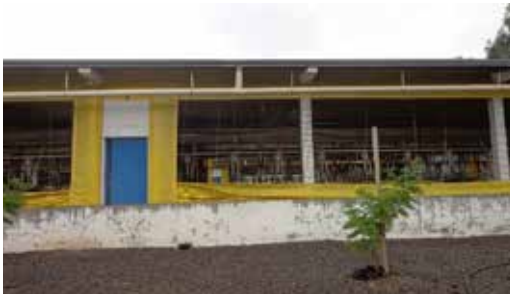
FOTO 02 | Vista lateral de um pavilhão de maternidade com o sistema de captação da água da chuva.
