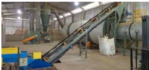
FOTO 30 | Fábrica de maravalha que utiliza a queima direta do biogás para secar o produto.
