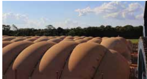
FOTO 13 | Uma série de biodigestores em pleno funcionamento.
