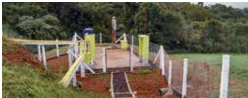
FOTO 25 | Sistema de regulagem da pressão do biogás dentro do biodigestor que utiliza água como controle de nível e queimador (flare) do excedente do biogás.
