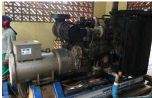
FOTO 14 | Gerador de energia elétrica a biogás.
