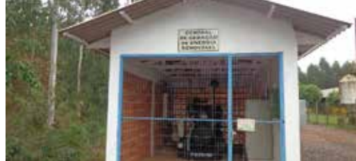
FOTO 27 | Central de geração de energia renovável.
