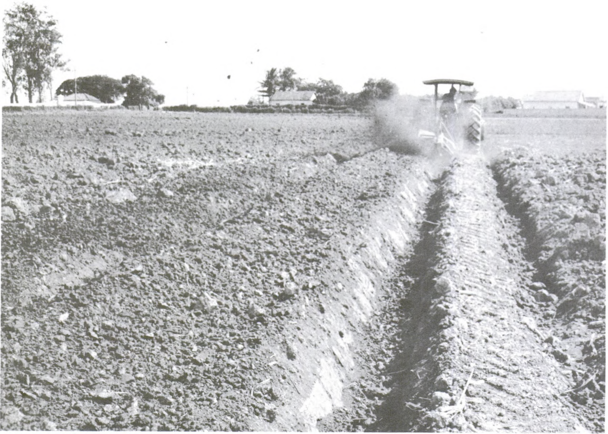
Construção dos coletores de drenagem do lote, feita por trator, com acabamento manual
