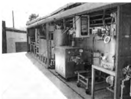
Plataforma de operaciones
