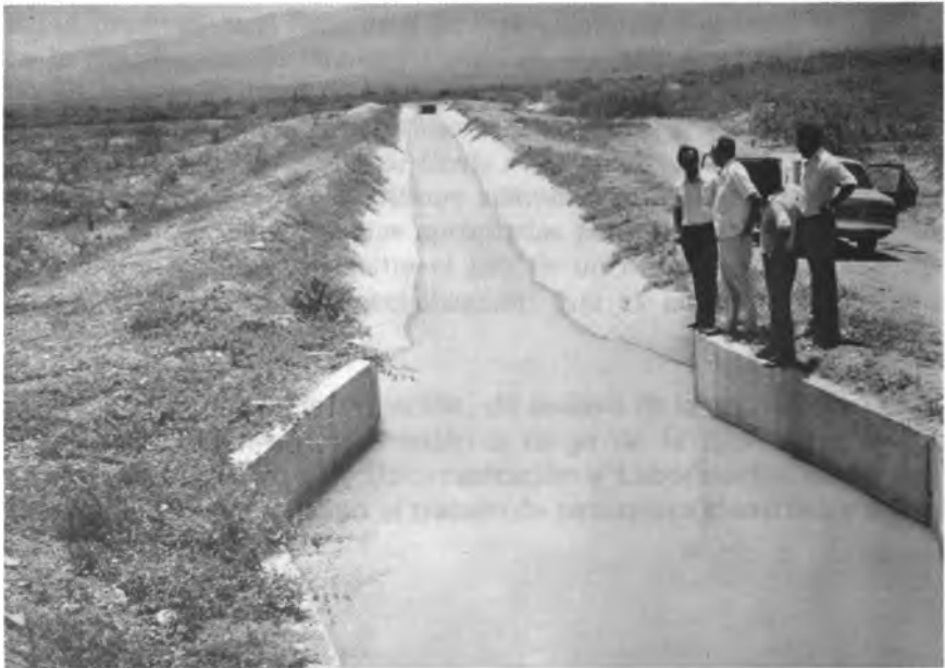
Aspecto de una infraestructura de riego, en República Dominicana.
