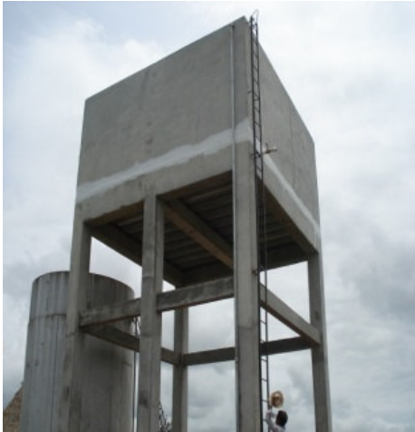
Ilustración 13 Tanque de captación de agua para la planta
