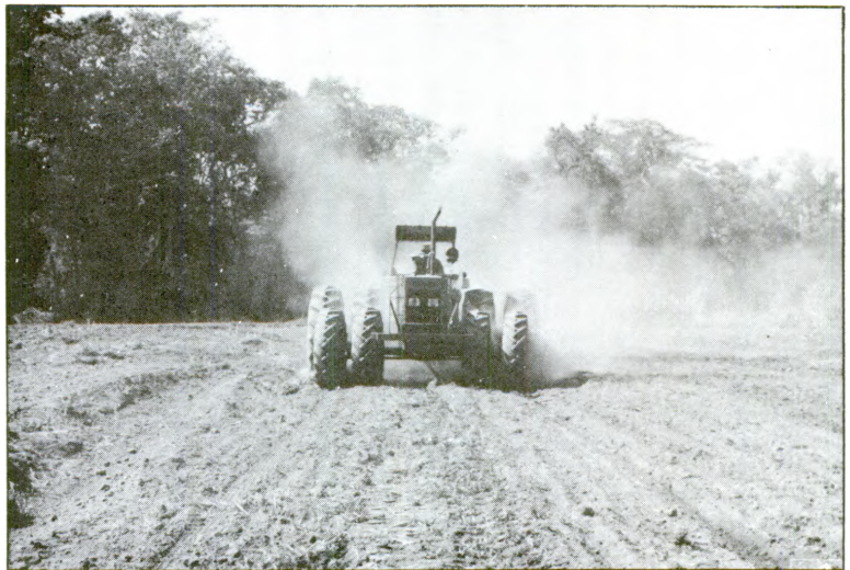
Final da limpeza do terreno com o trator e caçamba, para início dos trabalhos.
