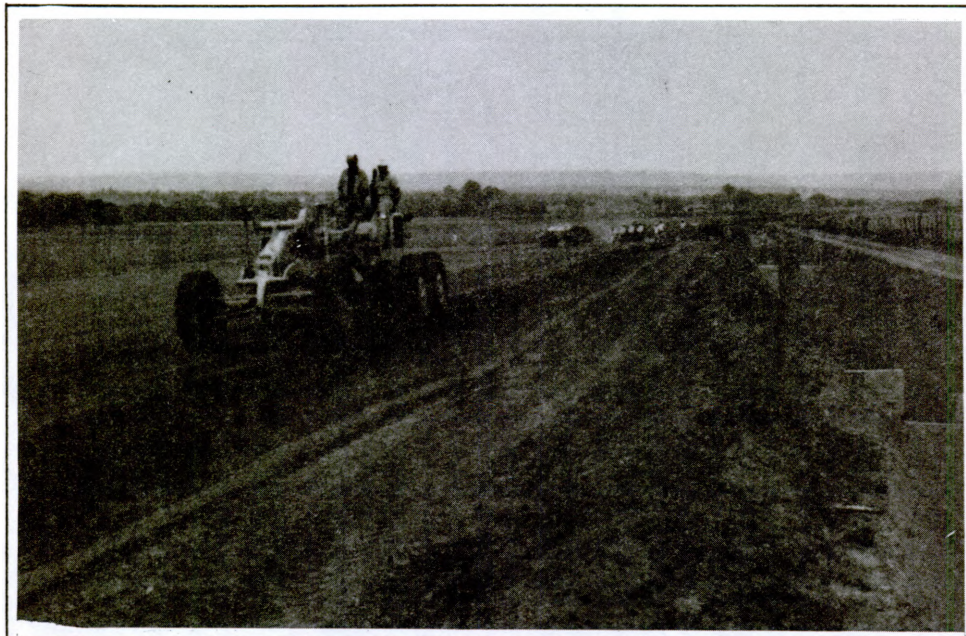
A direita da foto vê-se o canal condutor principal (com obras de salto em alvenaria) margeando a estrada de circulação interna, e à esquerda, a motoniveladora no momento em que distribua o material do bordo inferior do canal secundário irrigante.
