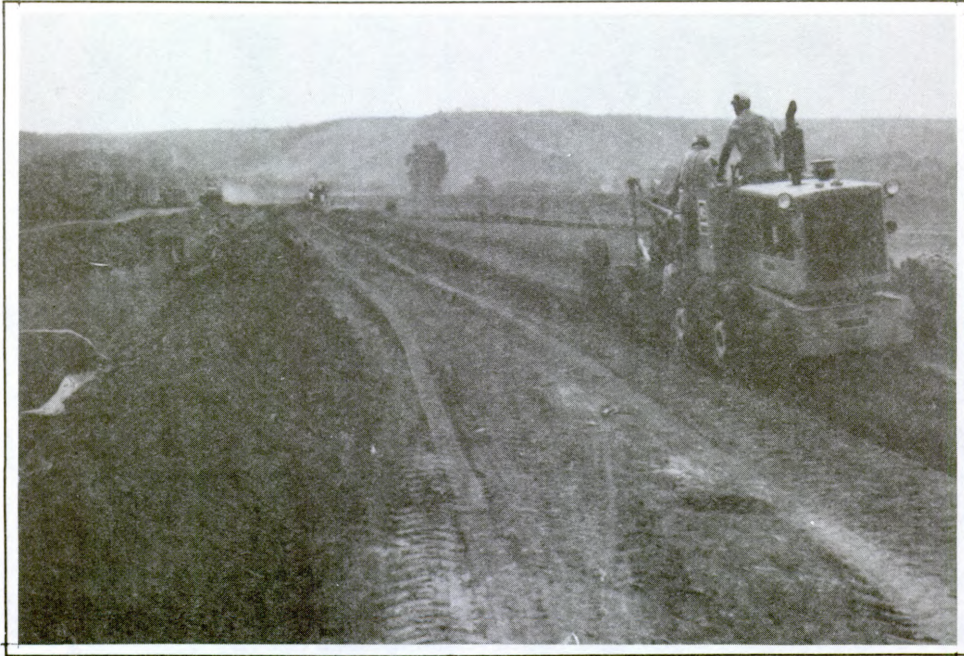
Segunda "passada" da motoniveladora para a construção da seção triangular do canal secundário irrigante. A esquerda, estrada margeando o canal condutor principal.
