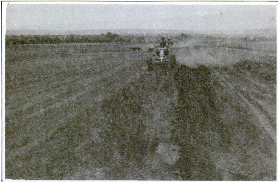
Rebaixamento da borda inferior do canal secundário irrigante sendo executado pela motoniveladora. À esquerda, campo nivelado preparado para a construção dos sulcos de corrugação.
