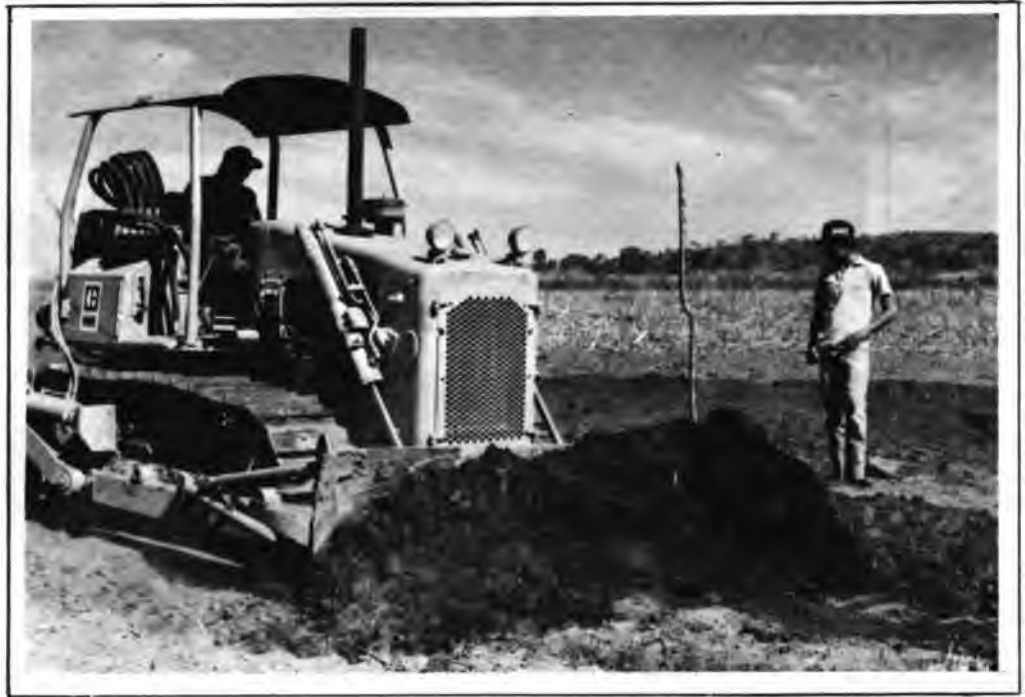
Cortes e aterros localizados feitos com a lâmina frontal para eliminar ou diminuir os acidentes topográficos. Feito somente pelo método de nivelamento por regularização.
