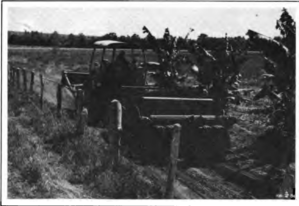
Outro tipo de plataforma construída em corte para o canal principal. O material retirado das partes altas serviu para o aterro deste canal nas partes baixas.;
