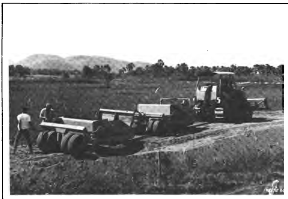
Aterro do canal principal no Setor II. Note-se o uso dos dois scrapers para transporte e distribuição do material.
