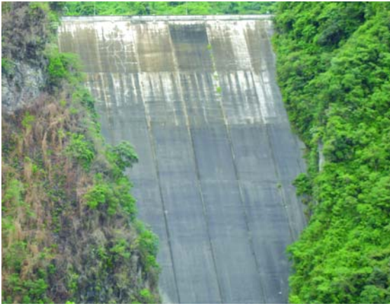
La Presa "Ing. José María Ochoa Pile", vista desde el lado interno de la "taza" recolectora del Río Yacambú.
