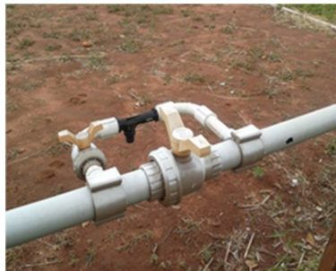
Figura 103. Proyector venturi instalado
