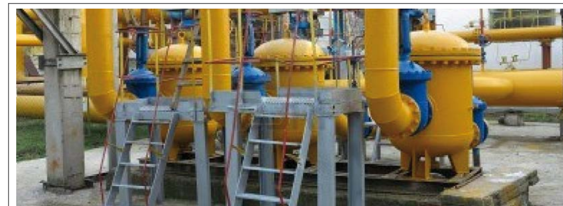
Tuberías de gas natural
