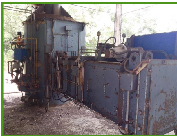
Equipos de incineración en el AIGL previo reparación.
