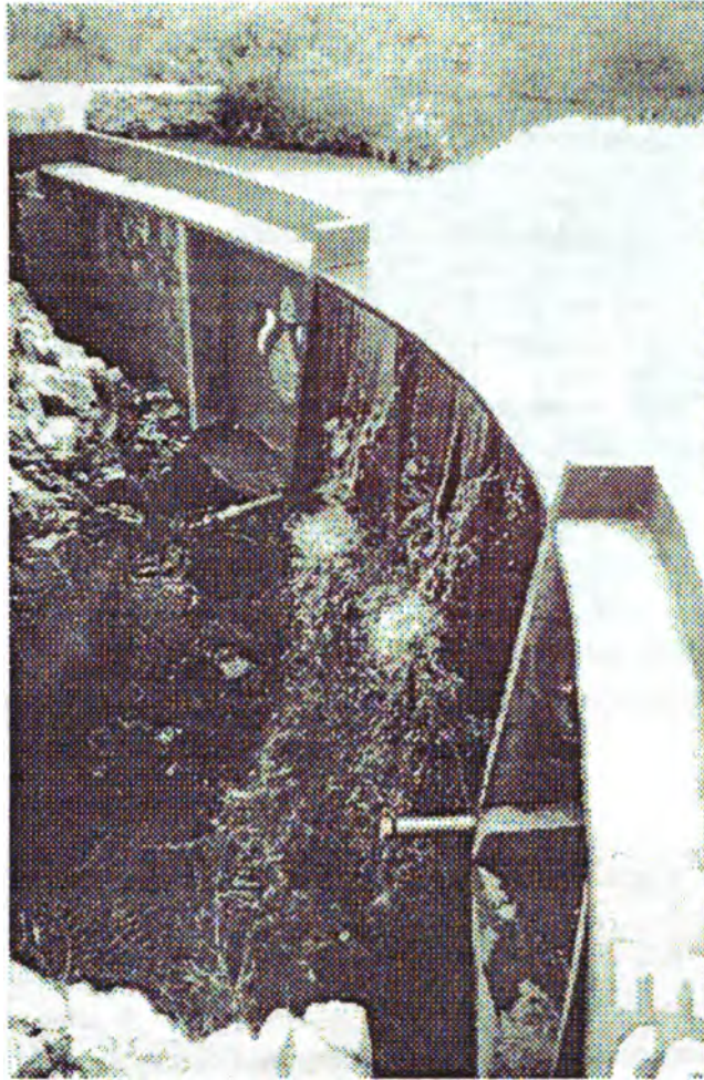
Fig. 2 Cortina de ferrocemento de un arco construido en San Felipe Tejalapam Etlá, Oax.
