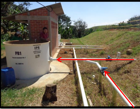
1 y 2. Tanq. De Bombeo (PB1)
