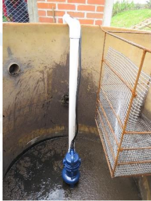
4 y 5. Descarga Motobomba
