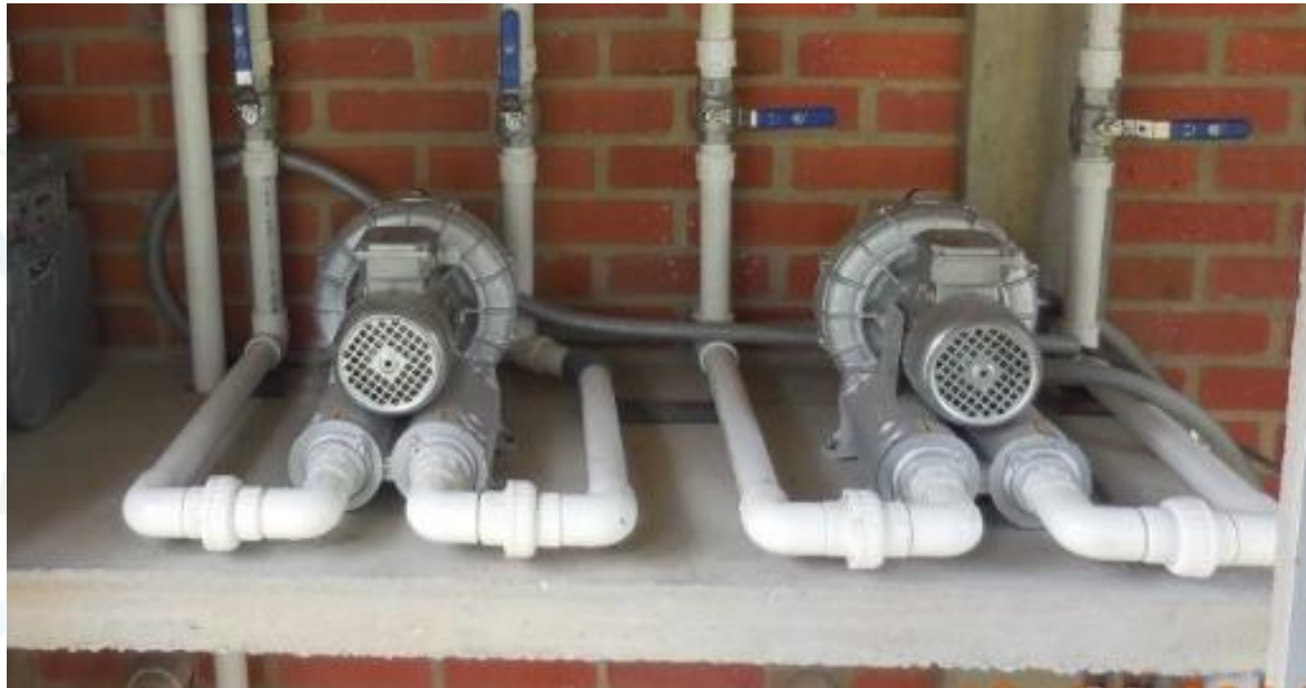
Sopladores de Biogás
