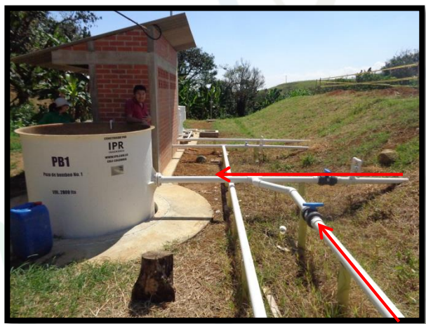
1 y 2. Purga de lodos
