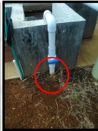
2. Válvula de Recirculación
