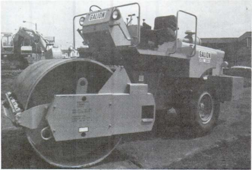
Fig. 74. Un rodillo vibratorio en sentido vertical para efectuar una compactación de suelo en obras de ingeniería civil.
